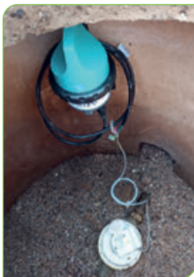
Compteur de sectorisation équipé du matériel de transmission à distance
